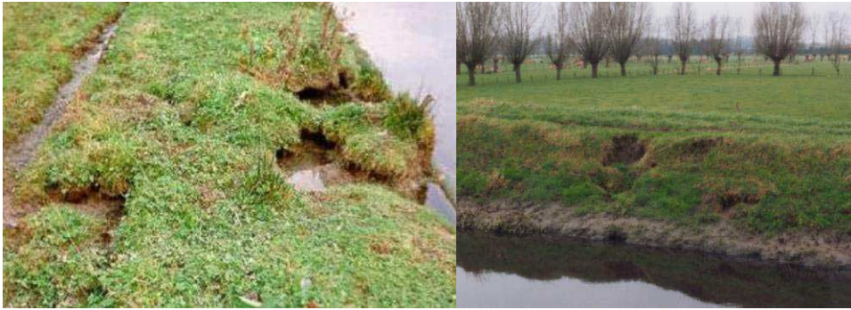
Figuur 12: Oeververzakkingen door graafschade van muskusratten.
