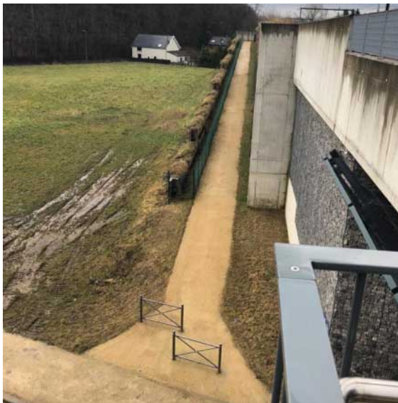
Rampe d'accès au quai de la voie 2, au niveau du croisement avec Chemin de Bourgeois.
