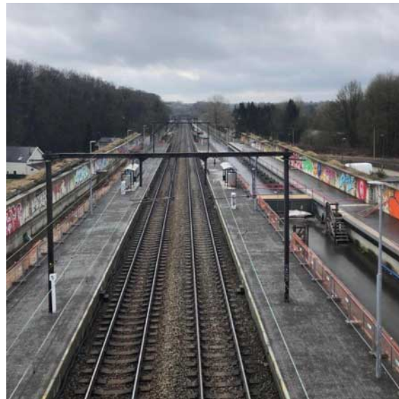
Van links naar rechts: tijdelijk perron (spoor 2), twee sporen in dienst, tijdelijk perron (perron 1), perron voor nieuwe sporen met tijdelijke toegang voor PBM's, nieuw perron toegankelijk (niet bediend).
