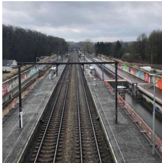
De gauche à droite : quai (voie 2) provisoire, deux voies en service, quai provisoire (voie 1), plateforme destinée aux nouvelles voies avec accès PMR temporaire, nouveau quai accessible (non desservi).
